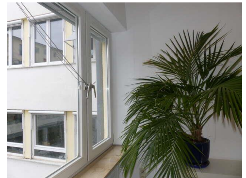
Abbildung 1: Fertige Laibungsdämmung. Es ist nichts zu sehen. So soll es auch sein.
