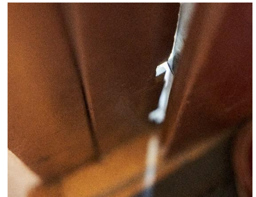
Abbildung 6: vor der Justierung – Spalt zwischen Schließpilzen und dem Schließblech
