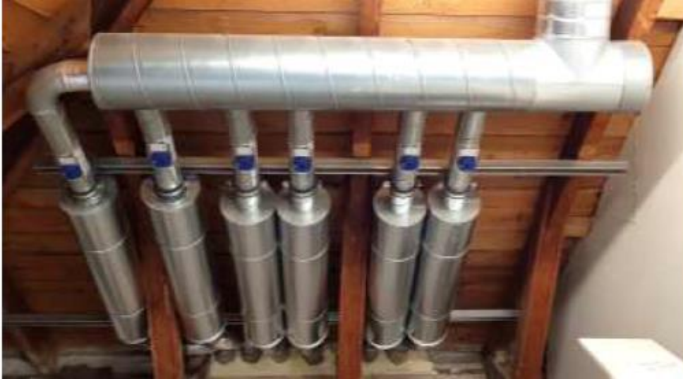
Abbildung 9: zentrale Anordnung von Konstantvolumenstromreglern und Schalldämpfern. Die Volumenströme werden einmal fest eingestellt, können aber bei Bedarf (z. B. bei Mieterwechsel) angepasst werden. Quelle: Neue Heimat Tirol
