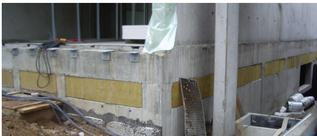
Abbildung 21: Thermische Trennung unterhalb der TG-Decke. Die Stahlbetonaußenwände sind in Stützen aufgelöst. Quelle: PHD
