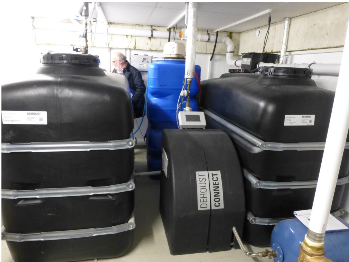
Abbildung 5: Ansicht der Grauwasseranlage für die Aufbereitung von gering belastetem Abwasser für die Toilettenspülung
